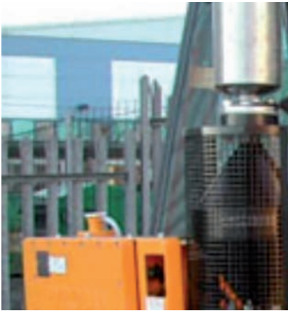
Figura 41 - Caja ignífuga de sistema de combustible.
