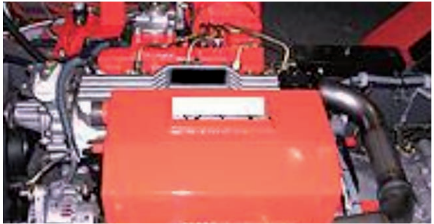
Figura 42 - Enfriador de gases de escape refrigerado por agua en primer plano y válvula de seguridad en segundo plano.
