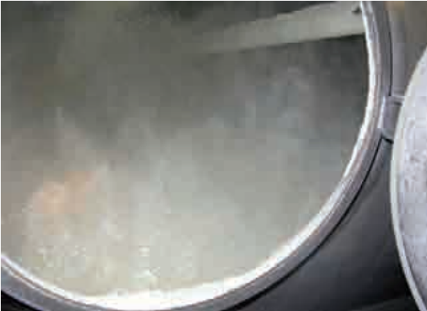
Figura 13 - En esta imagen se observa luz entre el polvo pero no se puede distinguir la luminaria que la proyecta.
