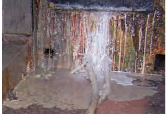
Figura 16 - Los derrames y acumulación de sustancia inflamables deben ser eliminados inmediatamente con procedimientos adecuados para evitar su filtración.
