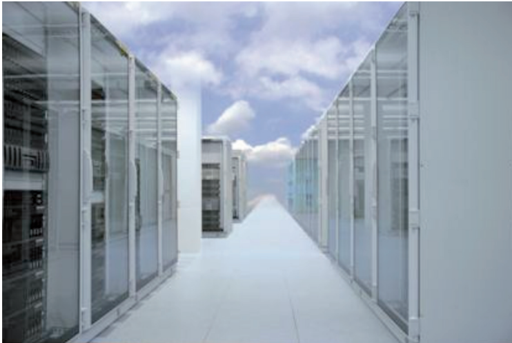
Figura 7.4. Imagen de centro de proceso de datos
